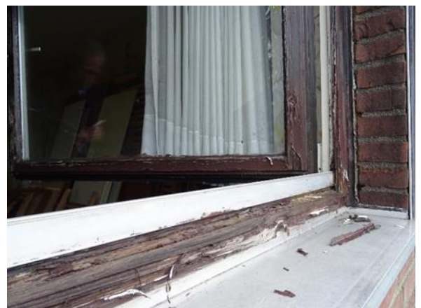
OG: verwitterte Holzfenster
